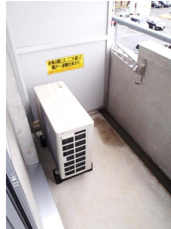
ベランダ (室外機)
